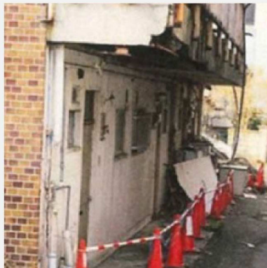
外壁剥落等の危険な状態
