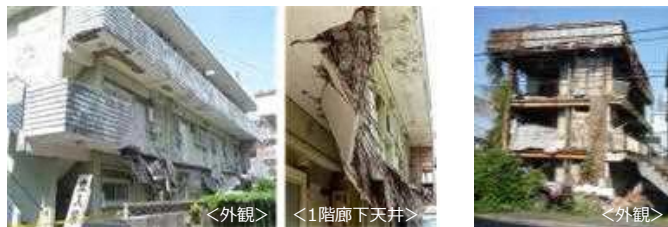
2階の廊下部分が崩落した事例
