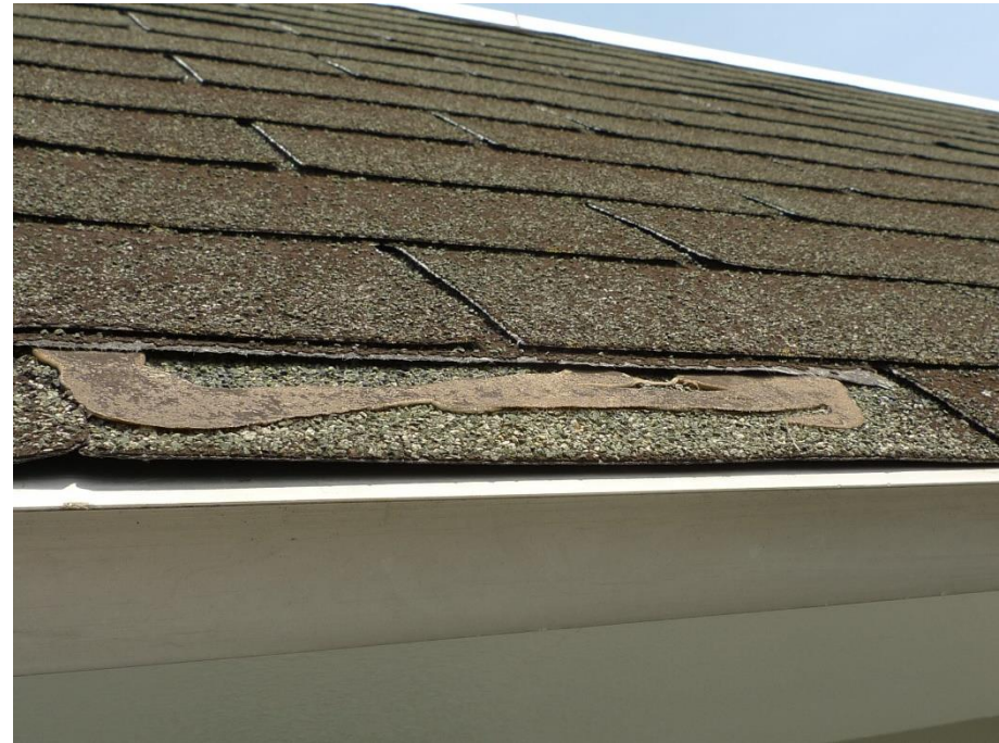
勾配屋根の剥離
