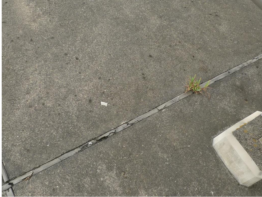
屋上防水：目地の劣化
