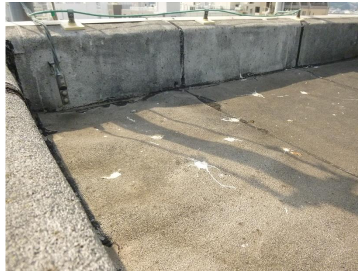
防水シートの剥がれや劣化
