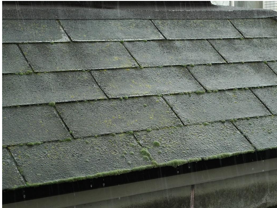
勾配屋根の劣化
