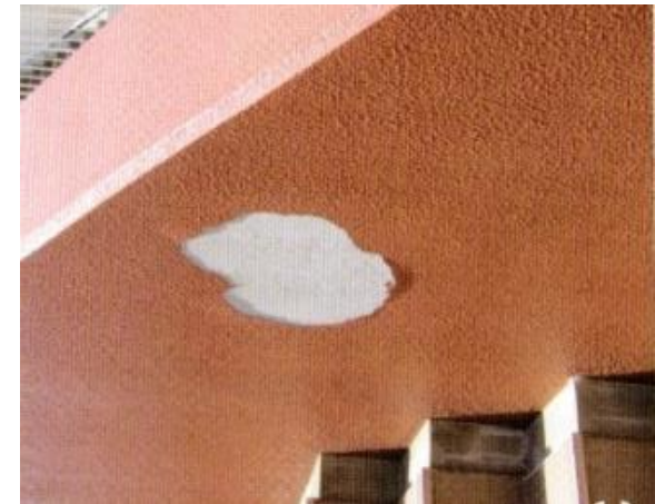
塗装仕上げ剥がれ
