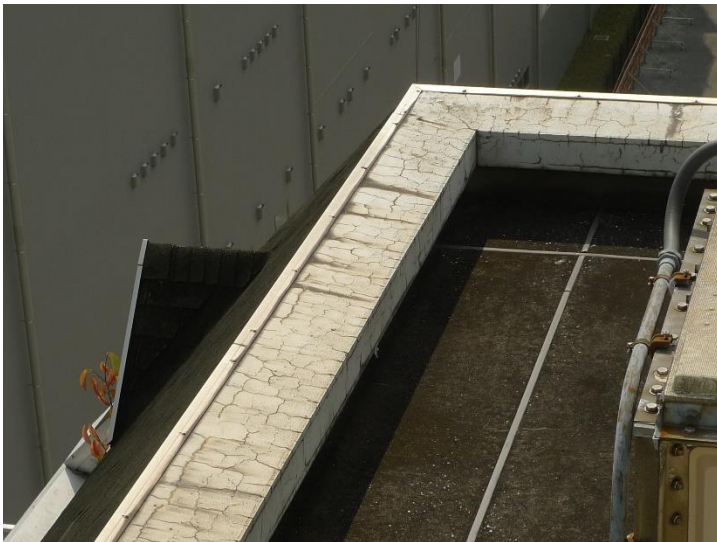
パラペット天端の笠木の劣化
