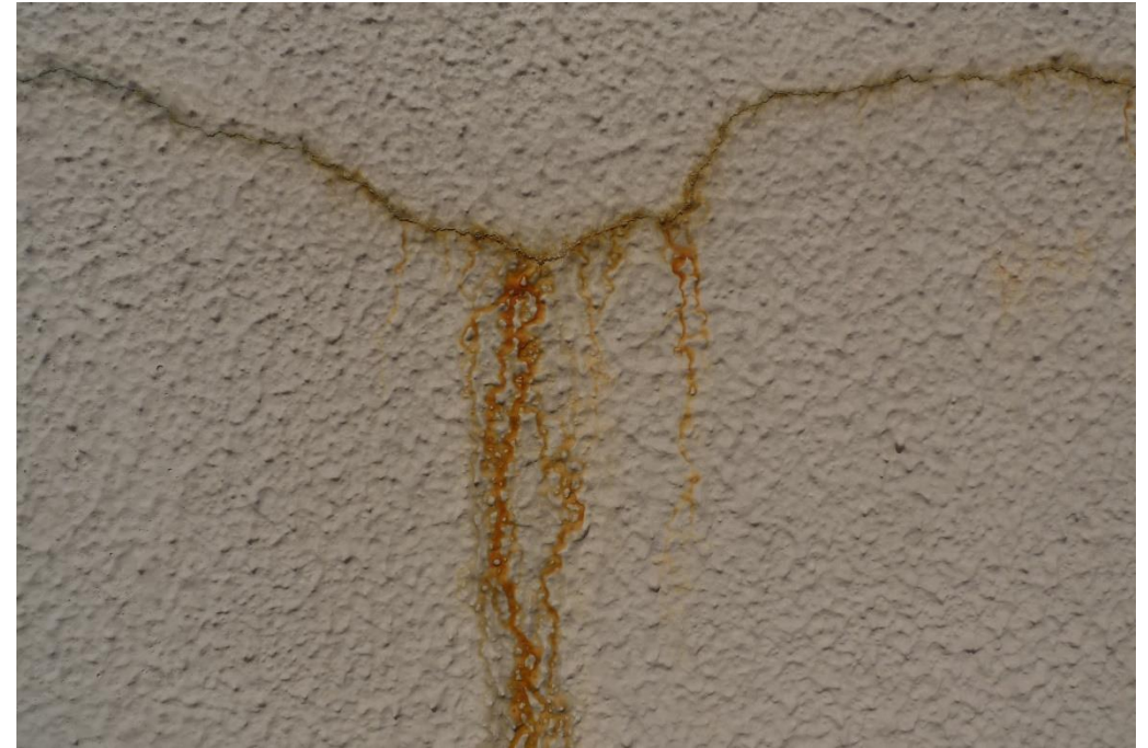
鉄筋コンクリート部のクラック、錆汁
