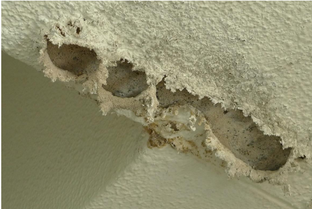
塗装面の劣化クラック、膨れ、脱落
