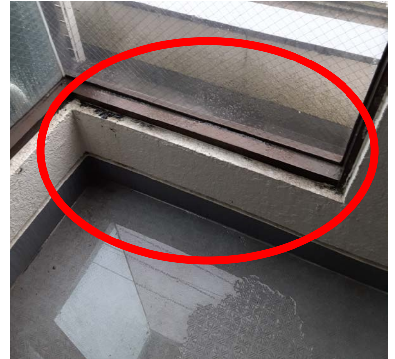
共用部窓枠の劣化による漏水
