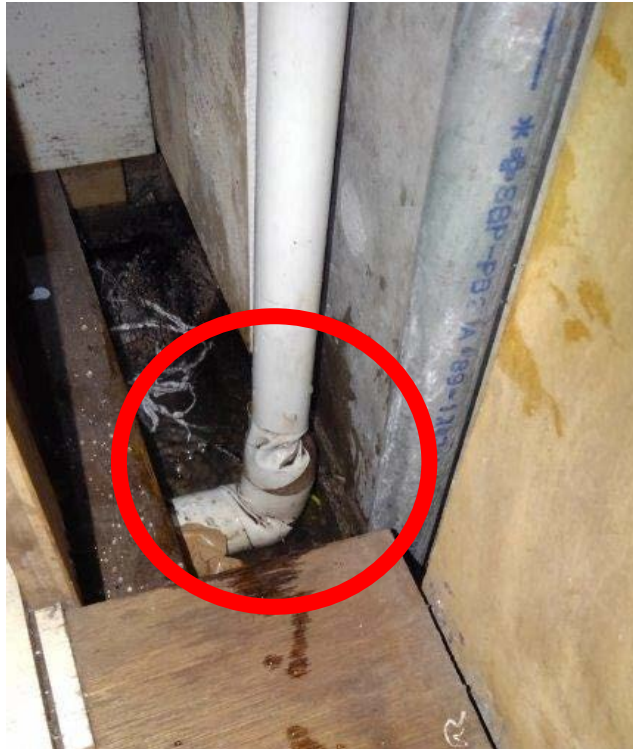
キッチンの配管接続部が脱落
