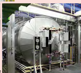
ボイラードラム Boiler drum
