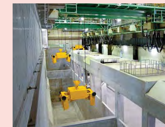
灰ビット/ 灰クレーン Ash pit & Ash crane
