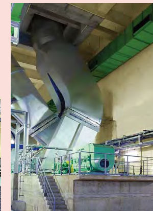
誘引通風機 Induced draft fan
