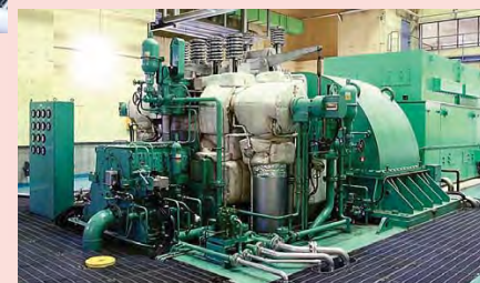
蒸気タービン発電機 Steam turbine generator
