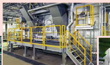
焼却炉本体 Incinerator
