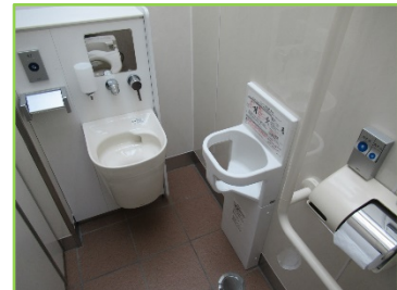
オストメイト対応・ベビーカー 西の橋公衆トイレ
