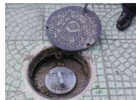
下水直結式仮設トイレ用マンホール
