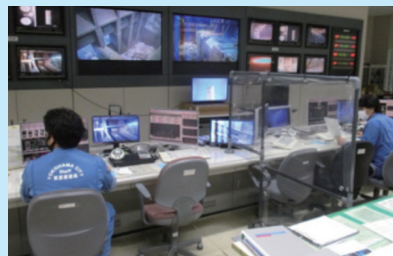
▲中央管制室 かんせいしつ の様子
