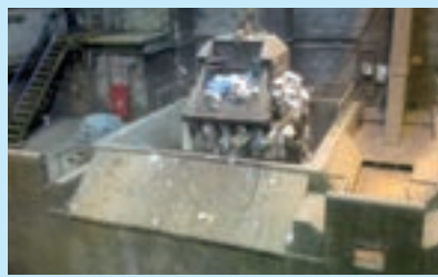
▲ごみクレーンで焼却炉にごみを入れる様子
