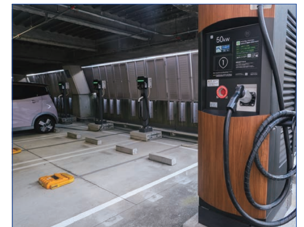
EV充電スタンド
