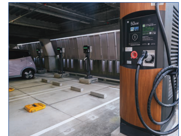
EV充電スタンド EVじゅうでんスタンド
