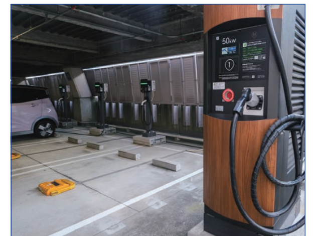
EV充電スタンド
