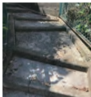
↑ひび割れが入った路面
