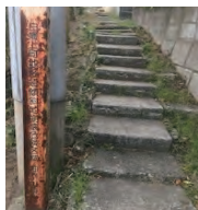
↑老朽化した階段（私道）
