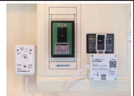
感震ブレーカーの設置例
