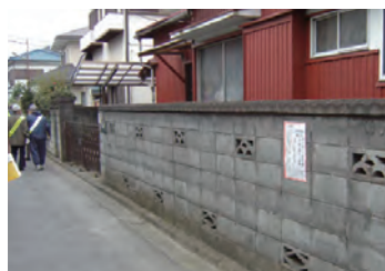
ブロック塀改善前
