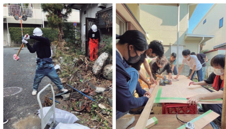
外構も含め建物の解体など、手掛けられる部分は住民の手で工事を行った
