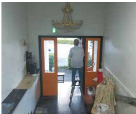
壁紙の張り替えや壁の塗装はメンバーに加え、近所の方も手伝ってくれた。
