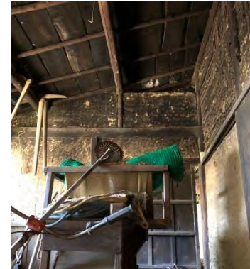
土壁補修が必要
