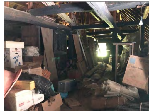
屋根裏床張替必要
