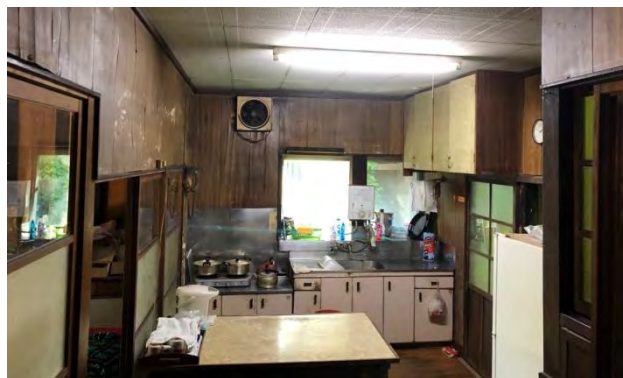
キッチン:全面的改修が必要
