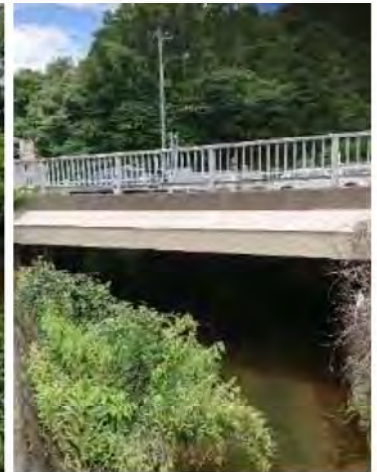
河川の氾濫・浸水土砂災害、 道路下のトンネル河川に木材・土砂流入による閉塞
