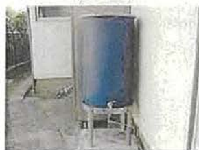
雨水タンク（東久保町会館）
