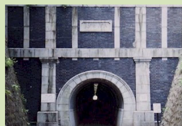
◆【道路】歴史を感じることができる創建当時のデザインを保全しています (南区南太田／大原隧道)
