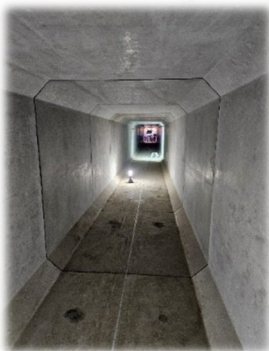
ボックス内部の状況
