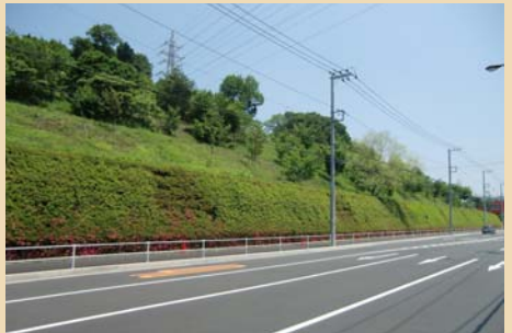
■ 擁壁に植栽ブロックを用いることで圧迫感や威圧感を軽減するとともに、背後の自然景観との調和を図っています（東京都町田市）
