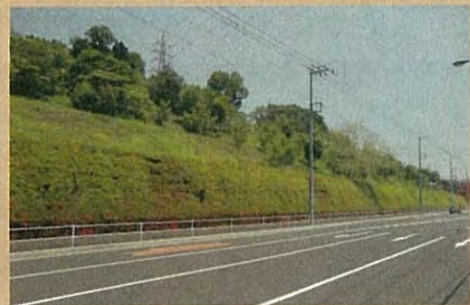
■ 道路際の擁壁が植栽ブロックであるため、圧迫感や威圧感を軽減するとともに、潤いを創出しています（東京都町田市）
