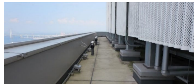
日常の屋上の照明配置(投光器)
