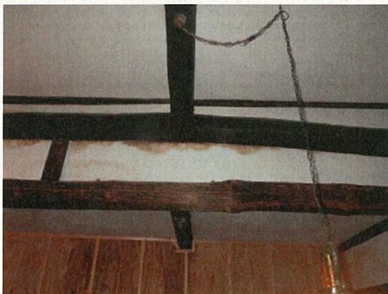
写真 3-18 主屋 垂壁の雨染み（[土間]北）
