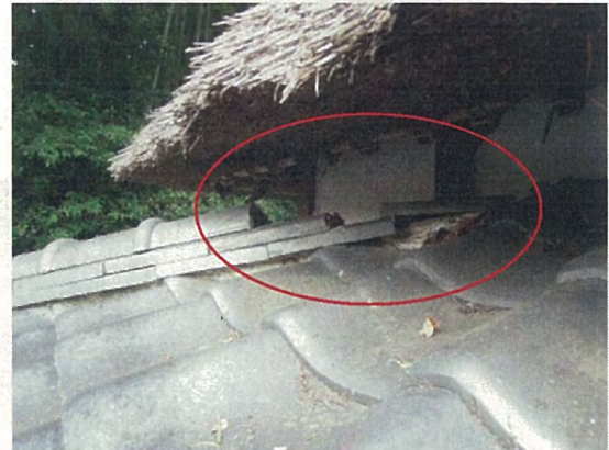
写真3-13 主屋 下屋隅棟の崩れ(北西)
