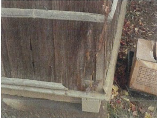
写真 3-30 東屋 外壁杉皮の破れ・押竹の折れ(南西)
