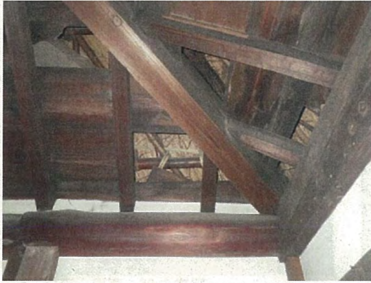
写真 3-20 主屋 野地板の外れ（〔内縁〕南西隅）
