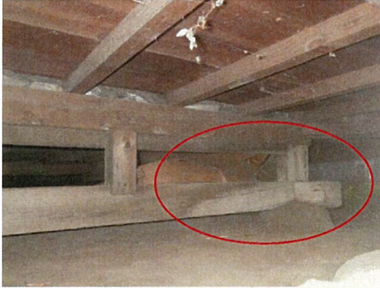
写真 3-3 主屋 土台の白色変色（南）
