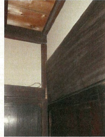
写真 3-6 主屋 差鴨居の捻れ・割れ (ダイトコロ・サシ境)
