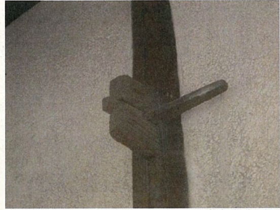
写真 3-26 東屋 梁の衷割れ(北)
