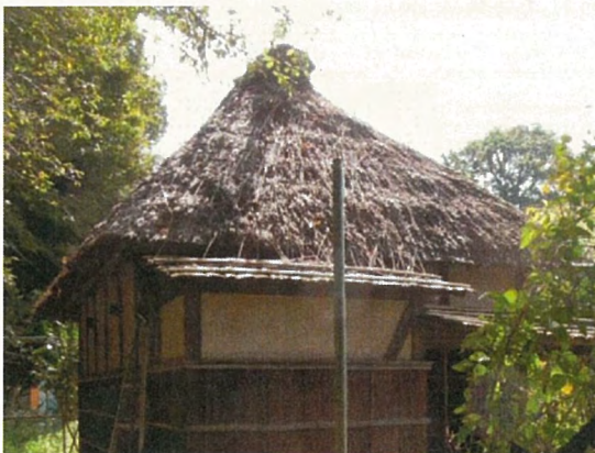
写真 3-28 主屋 垂木竹の縄抜け(西)
