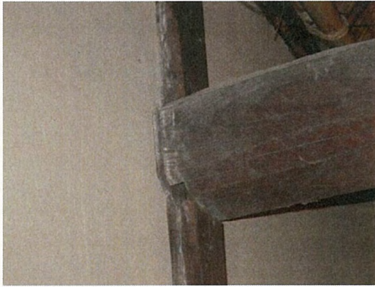
写真 3-25 東屋 柱・梁の仕口隙間(北)
