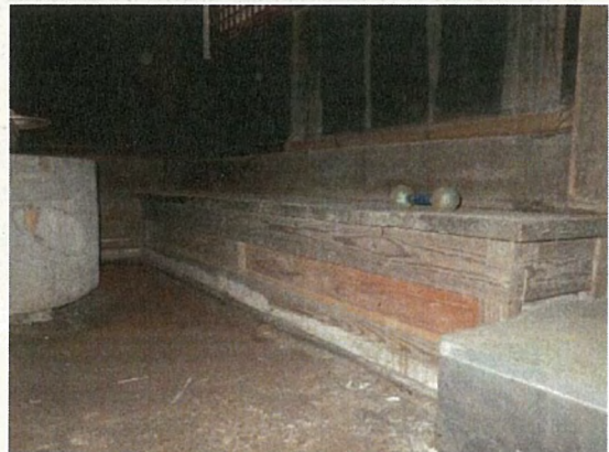
写真 3-17 主屋小縁の土台・蹴込板の雨染み （ダイドコロ）
