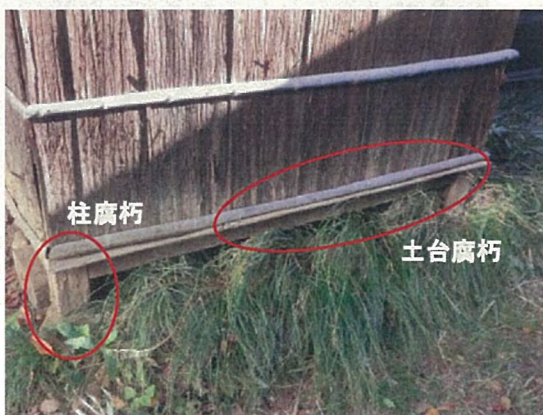
写真 3-23 東屋 柱の腐朽（北西）
