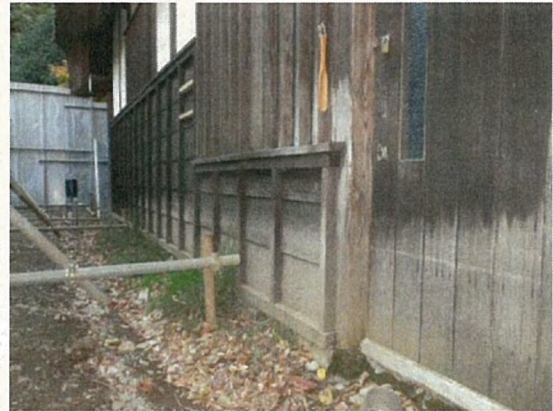
写真 3-15 主屋 下見板・建具下部の白色変色（東）
