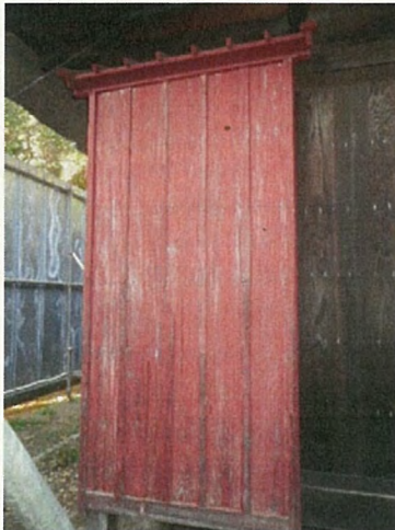
写真 3-16 主屋 戸袋の弁柄塗装剥離（南）
