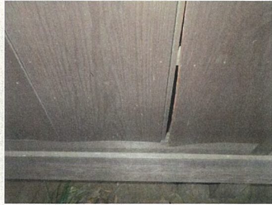
写真 3-21 主屋 雨戸縦板の反り・隙間（西）
