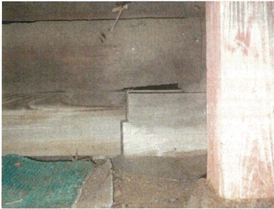
写真 3-5 主屋 土台の継手隙間（南）
