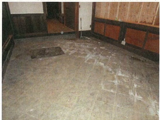
写真 3-19 主屋 タイル貼床の白華（[土間]）
