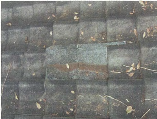
写真3-12 主屋 下屋棧瓦の部分欠損(西)
