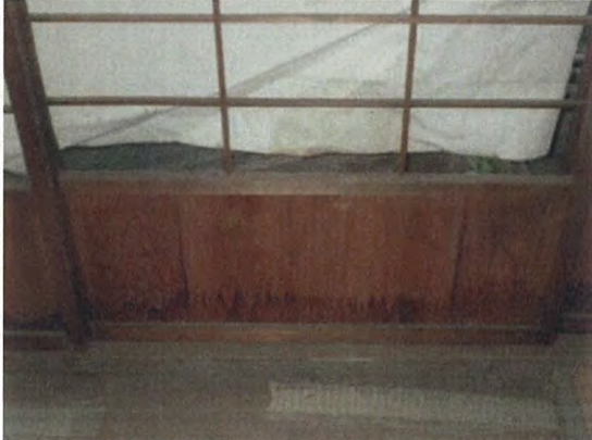
写真 3-32 東屋 建具の雨染み・障子破れ(南)
