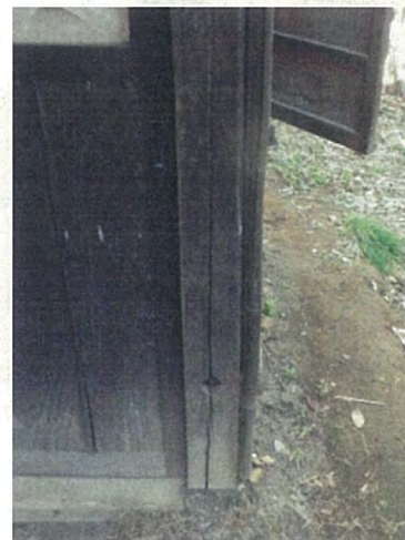
写真 3-24 東屋 柱の割れ・白色変色（南）
