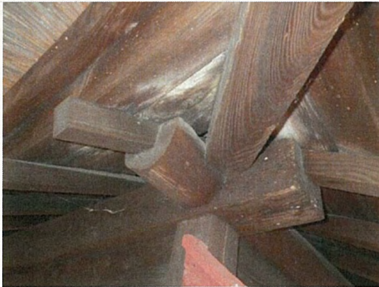
写真 3-14 主屋 化粧野地板の雨染み・白色変色（南西）
