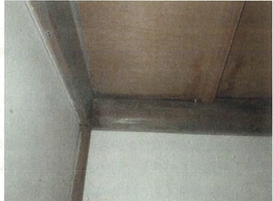
写真 3-31 東屋 天井板の雨染み([押入])
