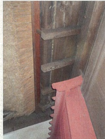
写真3-11 主屋 茅負の転び(西)
