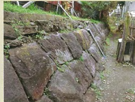
人工的な積層である神奈川台場石積みの様子 自然の積層との組み合わせ (台場保全エリア境界部)
