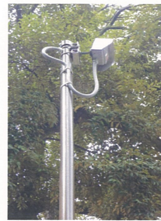
炎検知器 (ポール上布設)
