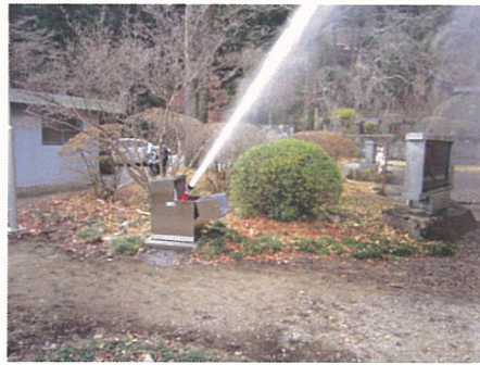
自動首振放水銃 放水中
