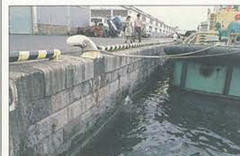
⑨新港埠頭石積岸壁 (明治38~44年) 第2次横浜築港の中核施設として築造されたわが国最初の繋船岸壁埠頭。この突堤形式の繋留岸壁埠頭は、コンテナ埠頭や堀込港湾が出現するまで港湾施設の主流となったものであり、新港埠頭はそのモデル的存在であった。
