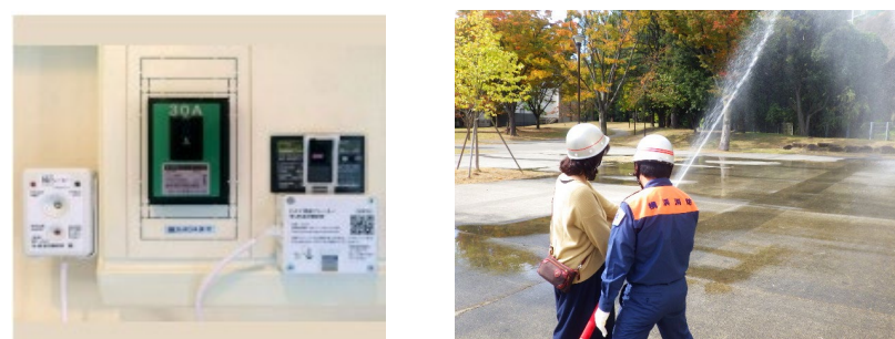
(左) 通電火災対策に有効な感震ブレーカー (中) 消火訓練の支援
