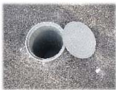
マンホールトイレ
