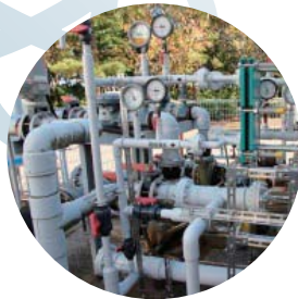
▲海水ヒートポンプ (株式会社横浜八景島)
