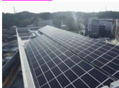
「戸塚区庁舎・太陽光発電設備」
