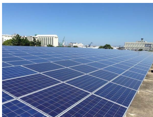
太陽光パネル（神奈川水再生センター）
