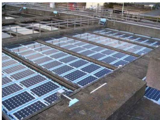
「小雀浄水場沈殿池・フロート型太陽光発電設備」
