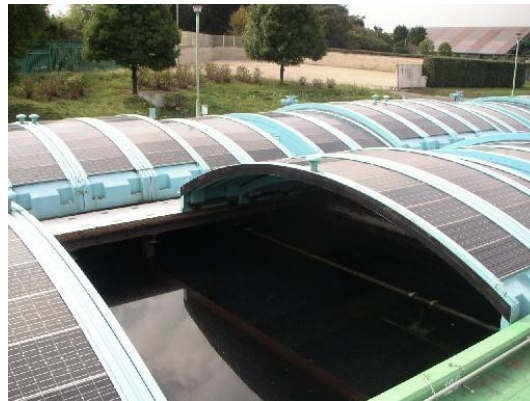
「小雀浄水場ろ過池 ろくわい ・覆蓋型太陽光発電設備」
