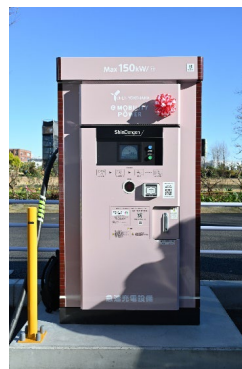
150kW超急速充電器
