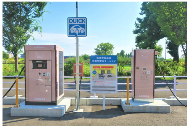
充電ステーション
