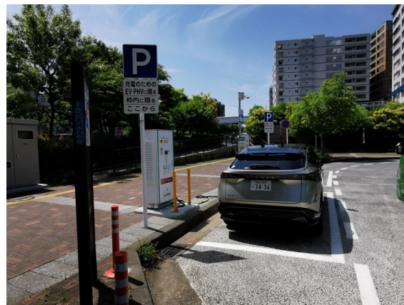
充電ステーション
