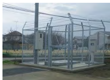
【写真】設置を支援した井戸施設（緑区）
