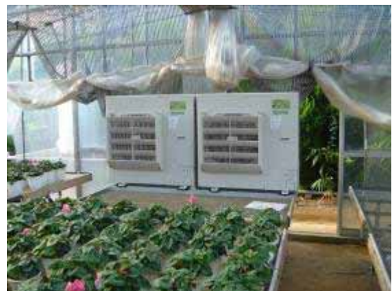
【写真】ヒートポンプを設置した温室
