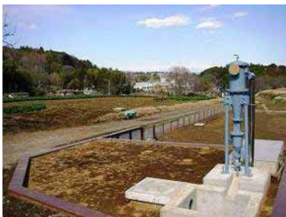
【写真】井戸及び配管整備 (緑区、向原地区畑地かんがい組合)
