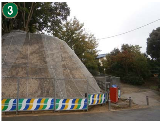
緑地再生等管理事業[市民の森等の斜面地での防災対策工事] (獅子ヶ谷市民の森)
