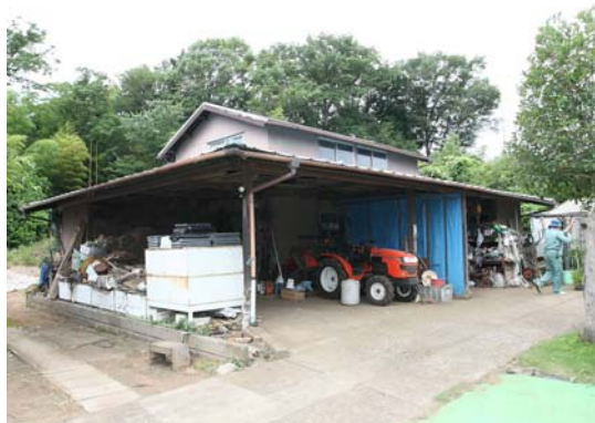
【写真1】農業機械格納庫 (戸塚区)
