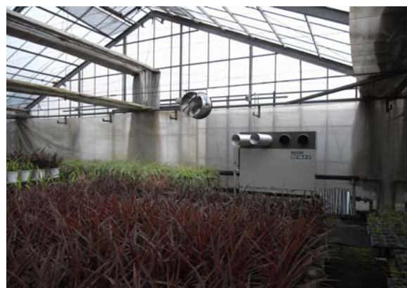
【写真】ヒートポンプを設置した花き温室 ヒートポンプは電気を用いた暖房器です。重油等を用いる加温機とあわせて使うことにより、加温機の燃料消費量を減らすことができます。
