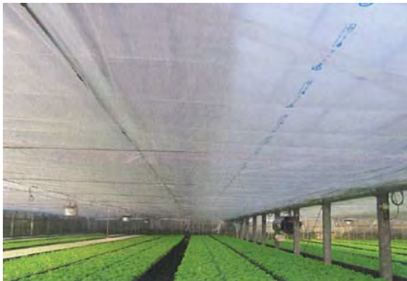
【写真】保温カーテンを設置した野菜温室 カーテンで温室を上下に仕切ることによって暖房空間を小さくして、加温機の燃料消費量を減らすことができます。
