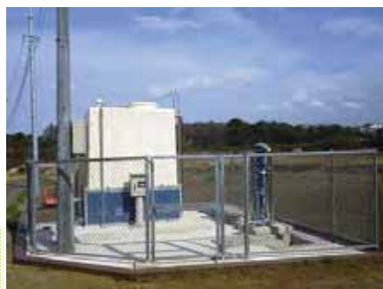
【写真】電気設備及び貯水槽整備 (緑区、向原地区畑地かんがい組合)
