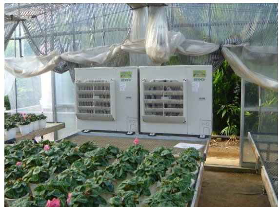
【写真】ヒートポンプを設置した温室
