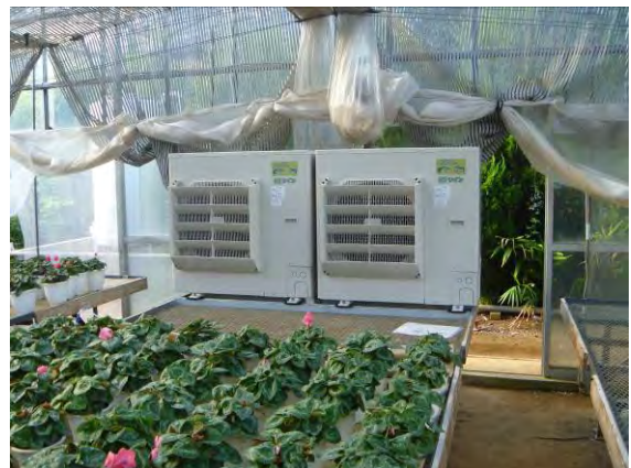
【写真】ヒートポンプを設置した温室
