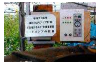
ヒートポンプ写真(制御盤)
