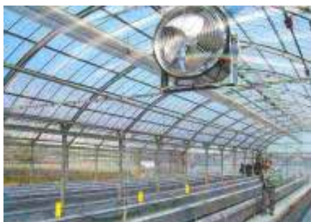
写真 施設の省エネルギー化推進事業 （ビニールハウスに設置した循環扇の様子）
