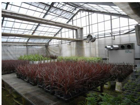
【写真】ヒートポンプを設置した温室
