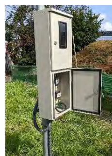
【井戸ポンプを動かす制御盤の更新】 （緑区）
