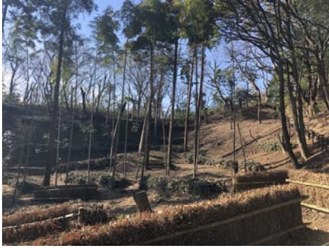
生物多様性にも配慮した防災や安全性の 対策工事を行った法面 (戸塚区／名瀬北特別緑地保全地区)
