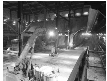
③釜利谷JCT Cランプトンネル工事 (栄区戸戸) 平成30年9月
